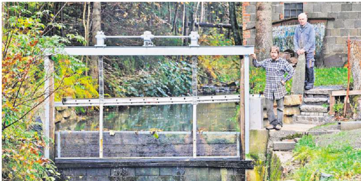
Das alte Grümpenwehr ist noch immer in Betrieb und bietet die Grundlage für die Stromgewinnung.
